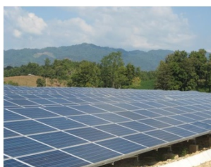
โรงไฟฟ้าพลังแสงอาทิตย์
